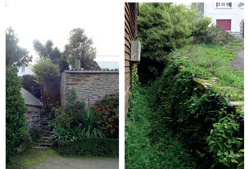
Dépendances en pierre structurant l'espace / mur en pierres sèches le long du local Croaë : stabilité à revoir + garde corps ?
